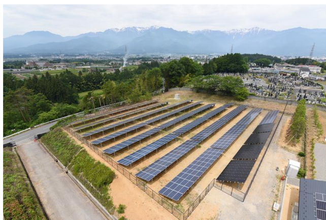
図表 58 リユース品を使用した発電所
